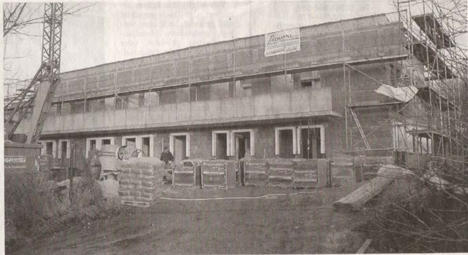
Nach einer kurzen Schlechtwetterphase sind die Bauarbeiter zum Rohbau des neuen Asylbewerberheims in Groß Reken zurückgekehrt. Foto: Liebetanz
